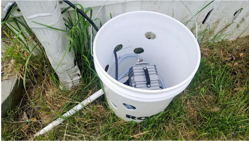
(用于给 Septic tank 加氧的 Air Pump)
